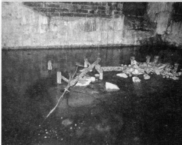
Pomieszczenie z podstawą pod obrabiarki zalane wodą.
