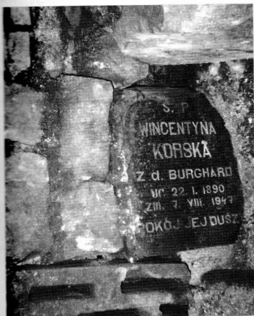
Płyta nagrobna wykorzystana do postawienia ścianki działowej w urządzonej w wyrobiskach pieczarkarni.
