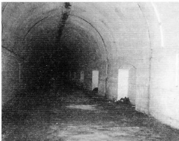
6. Wnętrze schronu kolejowego. Widoczna instalacja wentylacyjna na stropie i wężki na ogrzewane. Torowisko jest obecnie zabetonowane do poziomu peronów.
